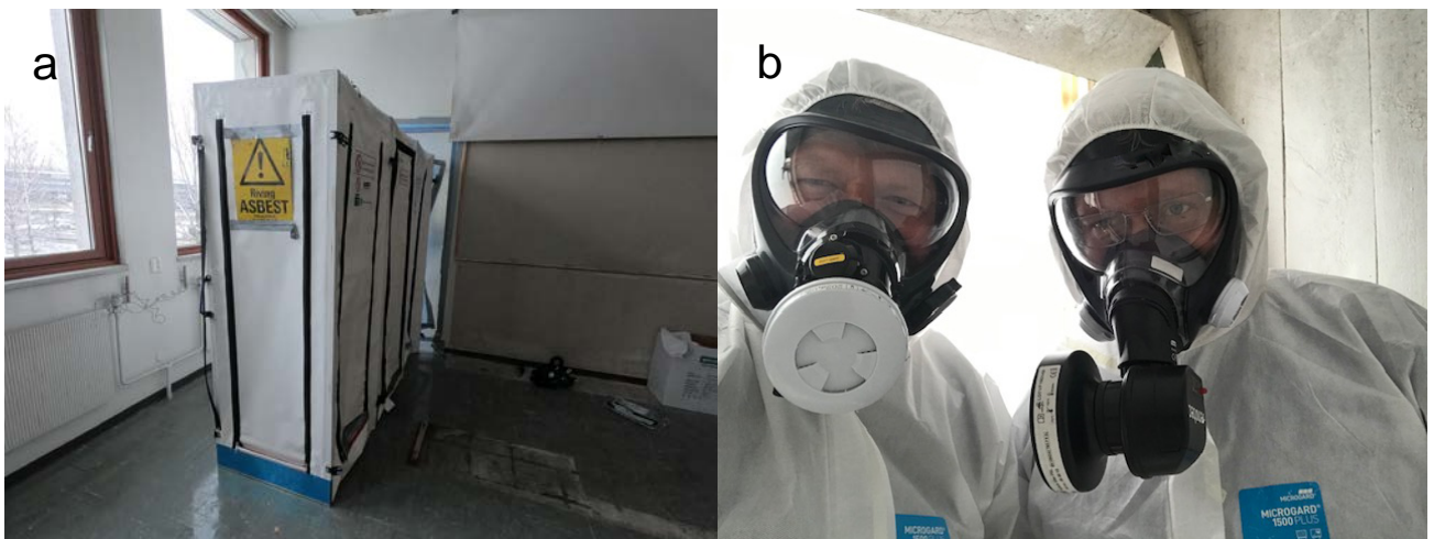
Figur 3.1: Figuren viser ett eksempel på sluse inn i område som saneres for asbest (A) og verneutstyr som benyttes ved asbestsanering – aktivt åndedrettsvern med P3 filter samt tette sluttende overtrekksklær (B).
