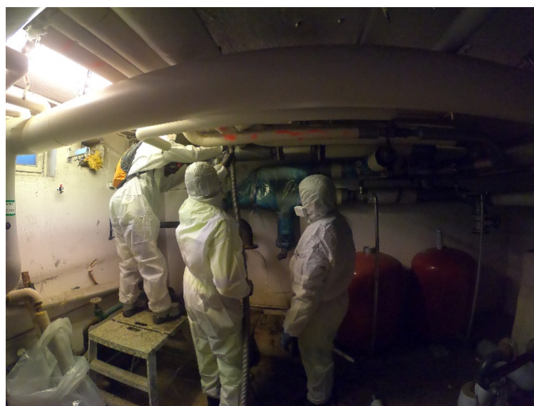
Figur 5.12: Bilde av rørsanering. Her er rørdelen som skal fjernes pakket inn i plast og den fjernes som en enhet.
