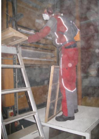
Filterskifte i kornsiloen
